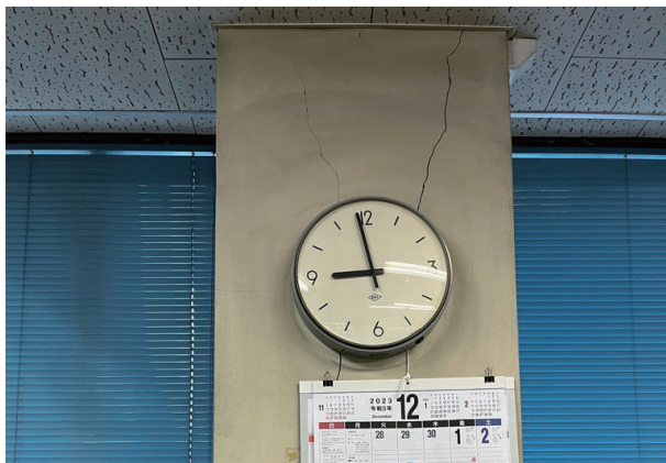
柱せん断破壊
