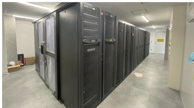
サーバー室の例（田辺市庁舎）
