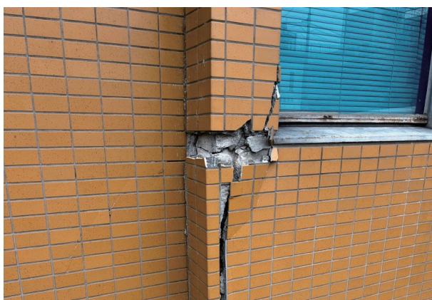
外壁タイル剥落2
