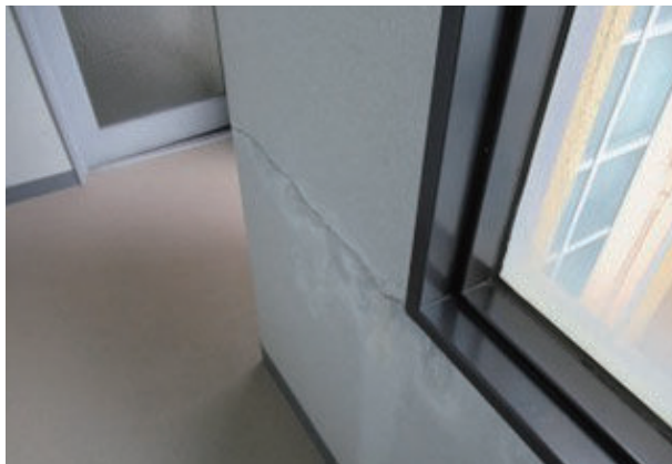
壁のひび割れ
