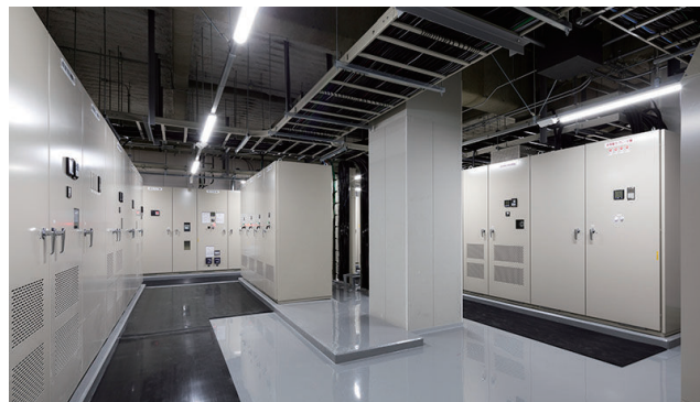
十分なメンテナンススペースの例（神奈川県東庁舎）
