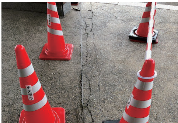
正面玄関前の土間のひび割れ
