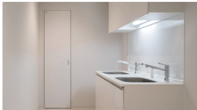
給湯室の例（神奈川県東庁舎）
