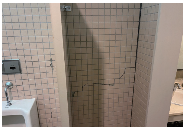
内部ひび割れ2
