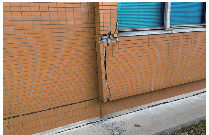
能登半島地震による本庁舎の被害
