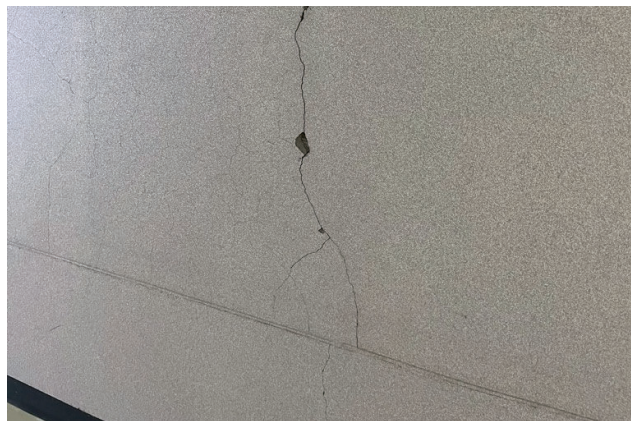
内部ひび割れ1
