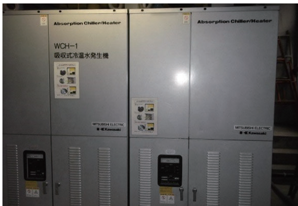
空調機器（平成 7 年更新）
