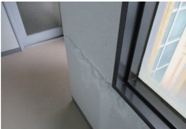
壁のひび割れ
