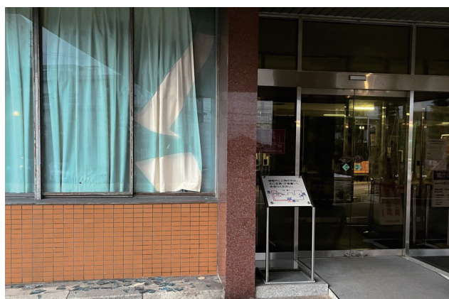
窓ガラスの破損
