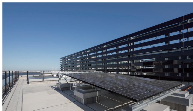
太陽光パネルの設置例（神奈川県東庁舎）
