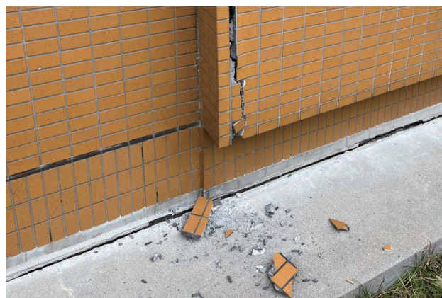
外壁タイル剥落1
