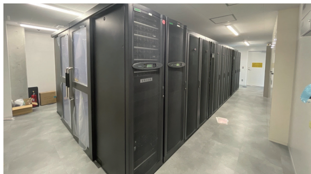
サーバー室の例（田辺市庁舎）
