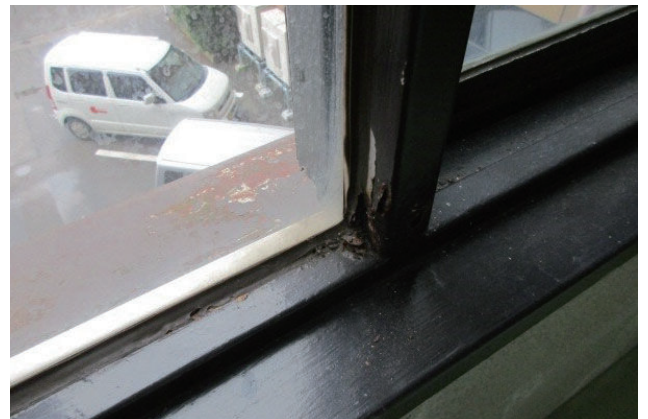
サッシの腐食
