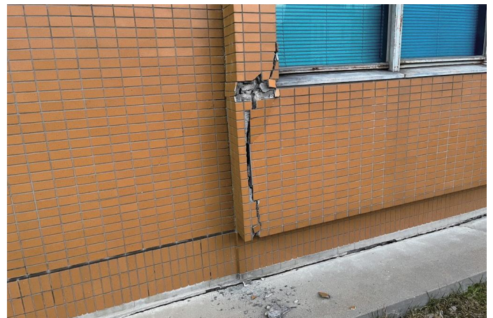
能登半島地震による本庁舎の被害
