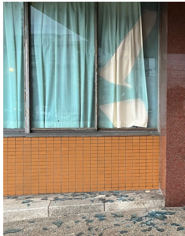
← 窓ガラスの破損
