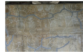
コンクリート橋のひび割れ
