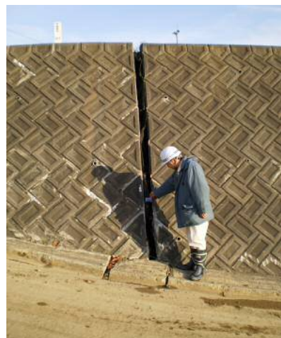
ブロック積みの隙間
