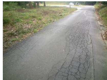
アスファルト舗装の 老朽化
