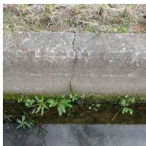
縦方向のひび割れ
