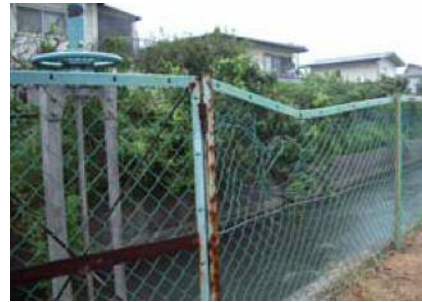
破損した金網フェンス
