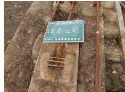
ため池における 老朽化したゲート
