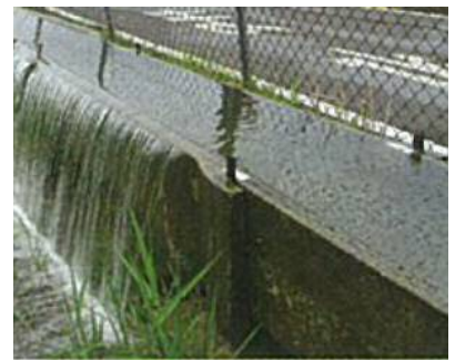
水路からの溢水
