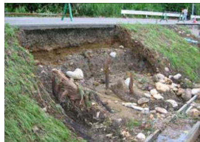
道路法面の崩壊
