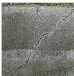
斜め方向のひび割れ
