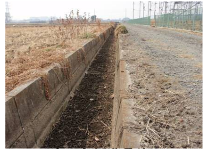
安全施設がない水路
