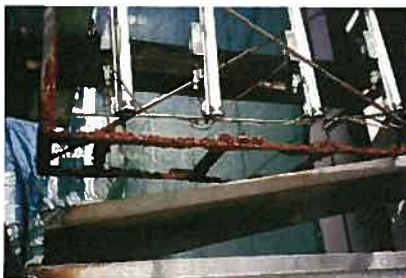
袖看板の底部脱落
