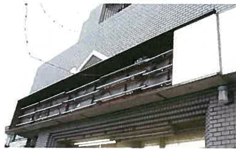
欄間看板の板面落下
