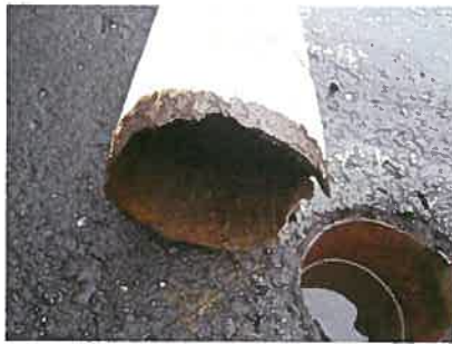
ポール看板の倒壊
