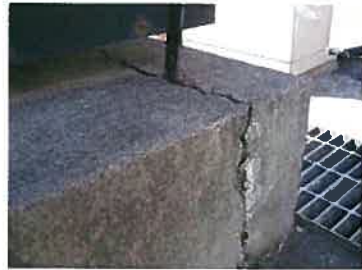
看板基礎のひび割れ
