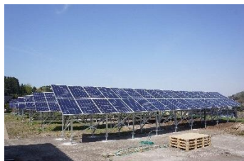
○臼谷太陽光発電所
