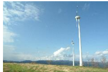
○稲葉山風力発電所
