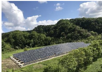
○八伏太陽光市民発電所
