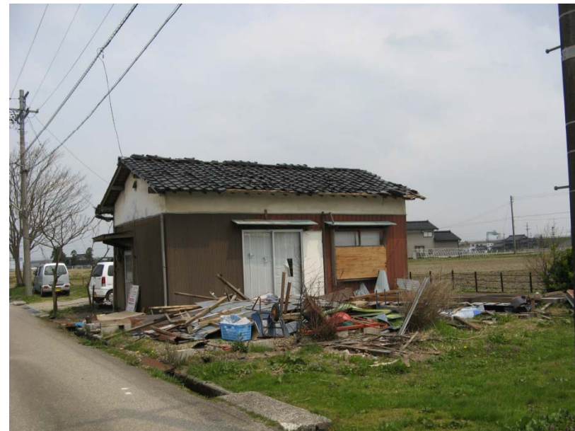
屋根瓦破損状況 2
