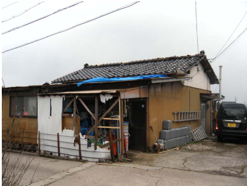
屋根瓦破損状況 1
