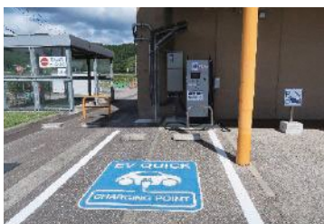
電気自動車充電施設
